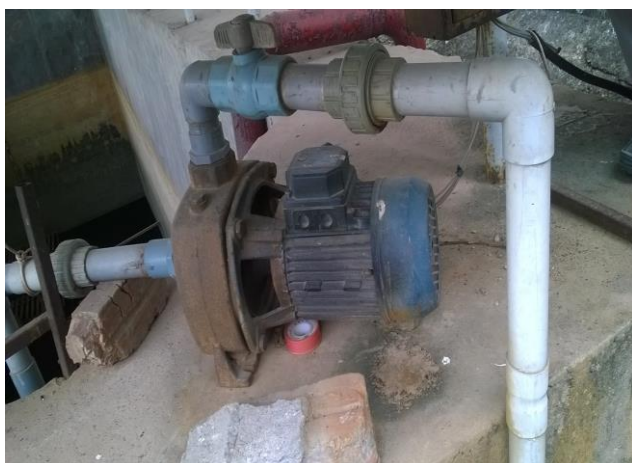
Hình 17. Máy bơm nước
