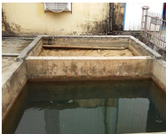
Hình 15. Bể lắng cát và bể chứa nước thải sau xử lý
