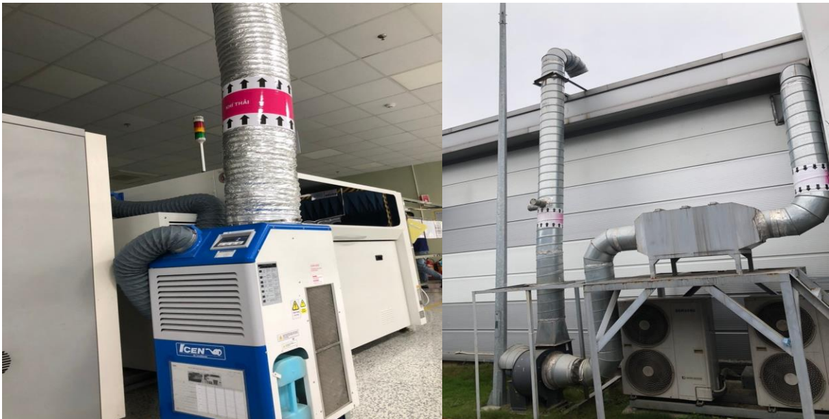
Hình 3. 6. Hình ảnh hệ thống thu gom và xử lý khí thải
