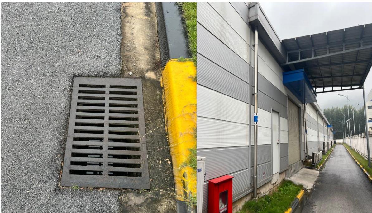
Hình 3. 1. Hình ảnh Công trình thu gom nước mưa bề mặt và ống thoát nước mưa trên mái
