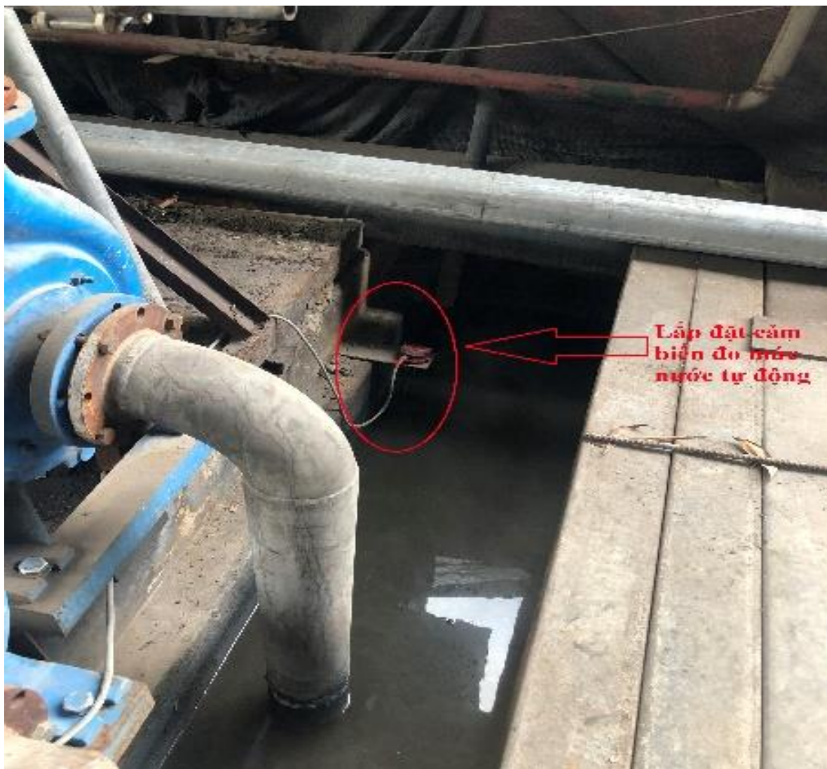
Hình ảnh máy bơm có lắp đặt cảm biến đo nước tự động Nguyên liệu sử dụng trong xử lý khí thải: Vôi bột: khoảng 1,5 tấn/tháng.
