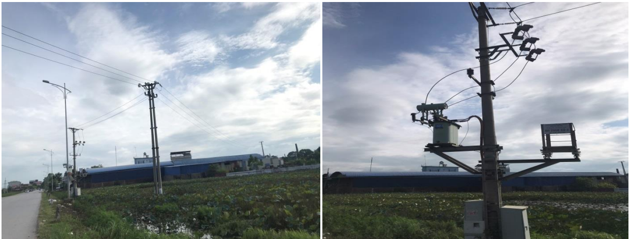
Hình 6. Đường điện và trạm biến áp trong ranh giới dự án
